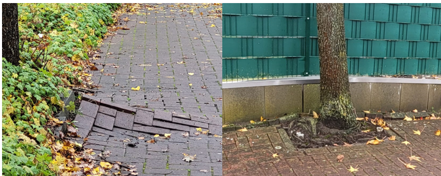
Das Wurzelwerk zahlreicher Bäume, die oftmals direkt an den Grundstücksgrenzen stehen, beschädigt sowohl öffentliche Gehwege, als auch private Grundstückseinfriedungen. (Fotos: Jens von Hebel)
